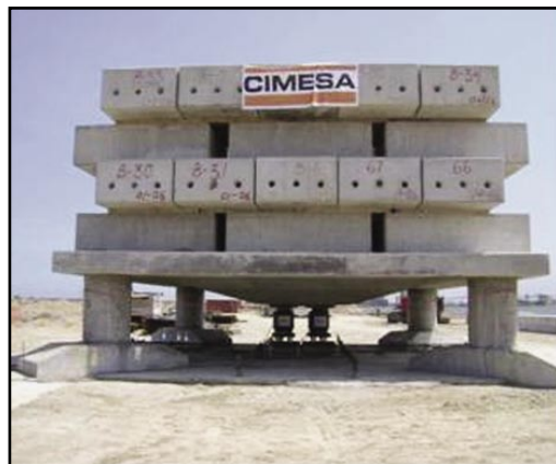
Figura 12. Vista en elevación de la estructura de lastre. Losa de transferencia y gatos de 1,000 Ton.
