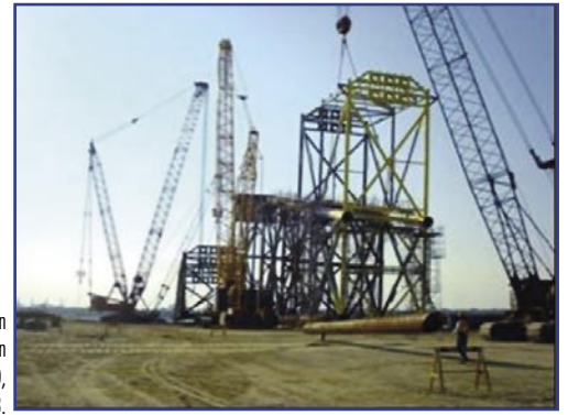
Figura 7. Maniobras de Colocación de estructura de plataforma con grúas tipo Manitowoc 18000, noviembre de 2008.
