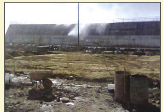
Oleaje de fondo rebasando el muro deflector del oleaje en el Puerto de Ensenada.
